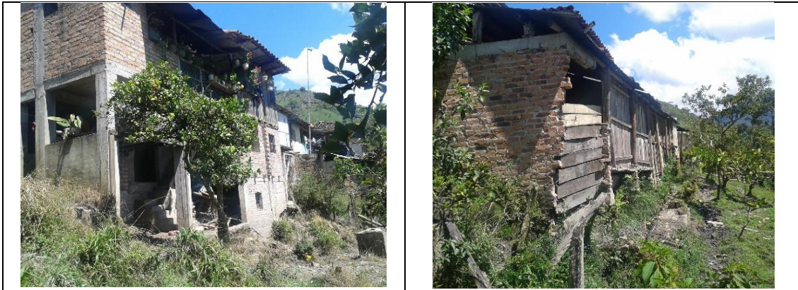
Viviendas en zona de amenaza alta por deslizamiento
