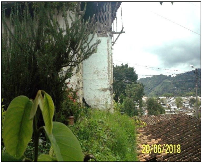
Ilustración 50. Vivienda afectada por proceso de tipo retrogresivo. Fuente: Geocing SAS.
