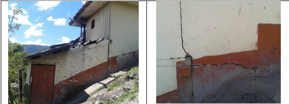
Viviendas con evidencias de deslizamiento, sus paredes están agrietadas
