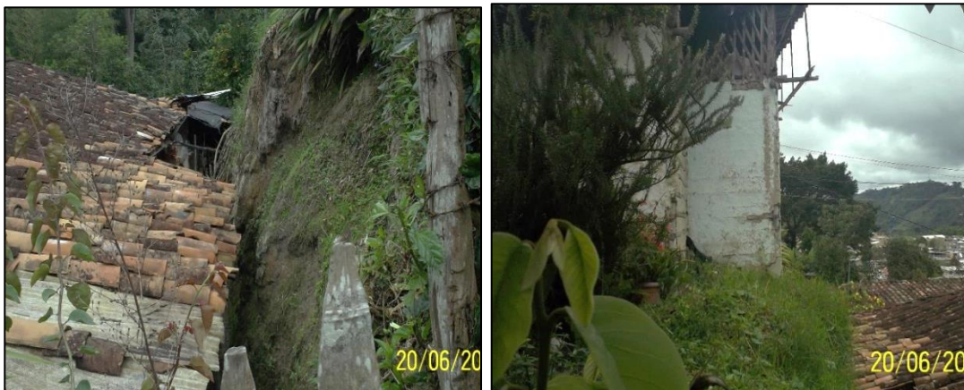
Ilustración 263. Se observa corte en ladera para la construcción de la vivienda del costado sur. La vivienda afecta en la parte superior del corte. Fuente: Geocing SAS.
