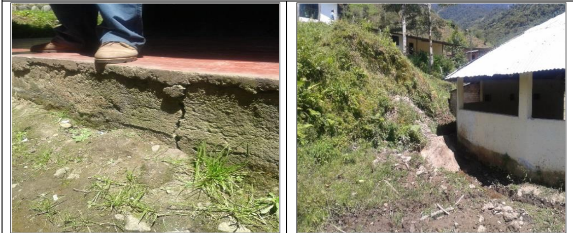
Zona posterior del colegio con alta humedad y evidencia de asentamientos
