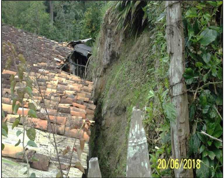
Ilustración 49. Se observa corte en ladera para la construcción de la vivienda del costado sur. La vivienda afecta en la parte superior del corte. Fuente: Geocing SAS.
