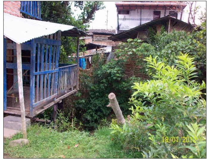
Ilustración 16. Panorámica Viviendas en riesgo de colapsar barrios Primero de Mayo y Santa Teresita. Fuente: (Municipio de San Agustín - Huila, 2012).
