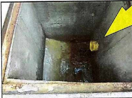
Salida del vertimiento hacia el sistema de alcantarillado municipal.
