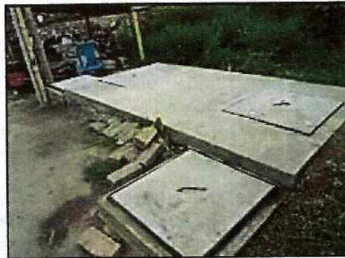
Panorámica del dispositivo de tratamiento de agua residual compuesta por tanque séptico (1), FAFA (2) y Cámara difusora (3).
