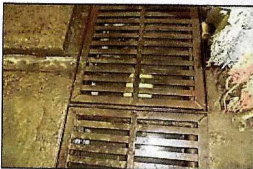
Desarenador dotado de rejilla a donde llegan las aguas residuales del área de lavado.
