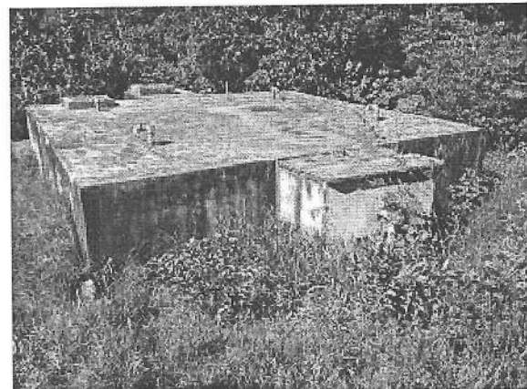
Fotografía 4. Tanque de almacenamiento.
