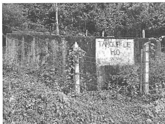
Fotografía 4. Tanque de almacenamiento.
