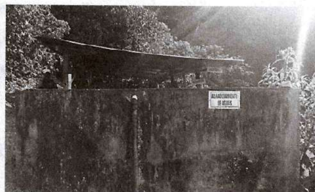
Fotografía 4. Taque de almacenamiento.
