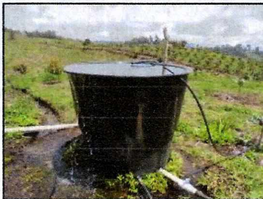
Tanque de almacenamiento E760963- N711830
