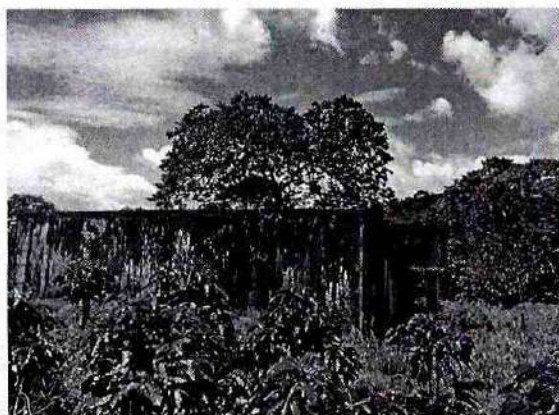
Fotografía 5. Tanque de almacenamiento 1
