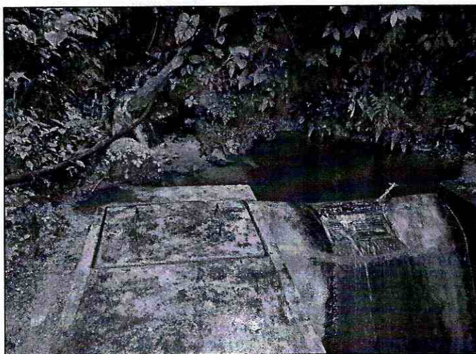
Captación sistema de acueducto vereda Betania del municipio de Palestina.
