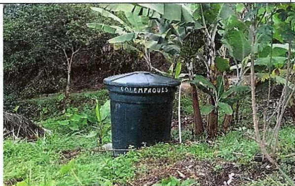
Fotografía 5 tanque de almacenamiento de 2000 litros, con flotador para controlar el recurso hídrico
