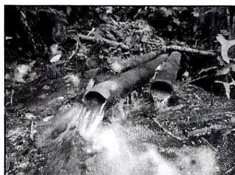
Entrada a tanque plástico (sedimentador)
