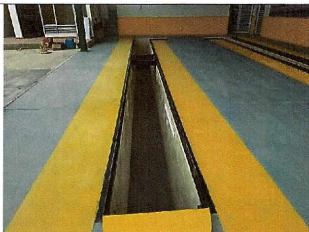
Fotografía 4. Cárcamo para cambio de fluidos
