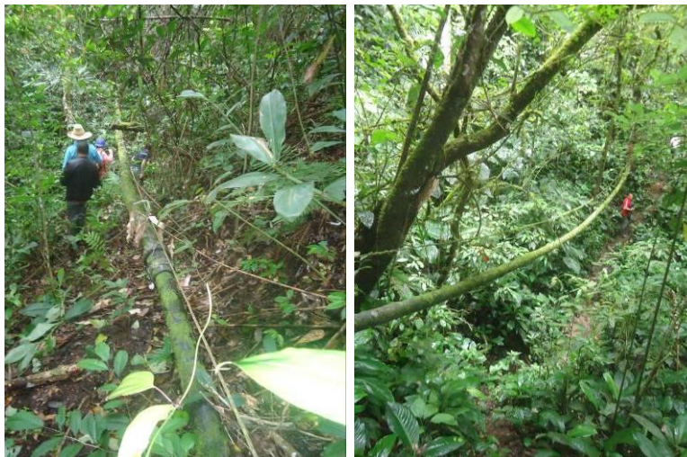
Red de conducción del flujo hídrico del ACUEDUCTO COLECTIVO LA PIRAGUA
