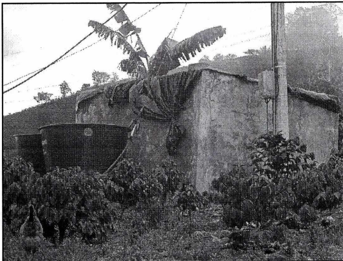
Tanque de almacenamiento No.1
