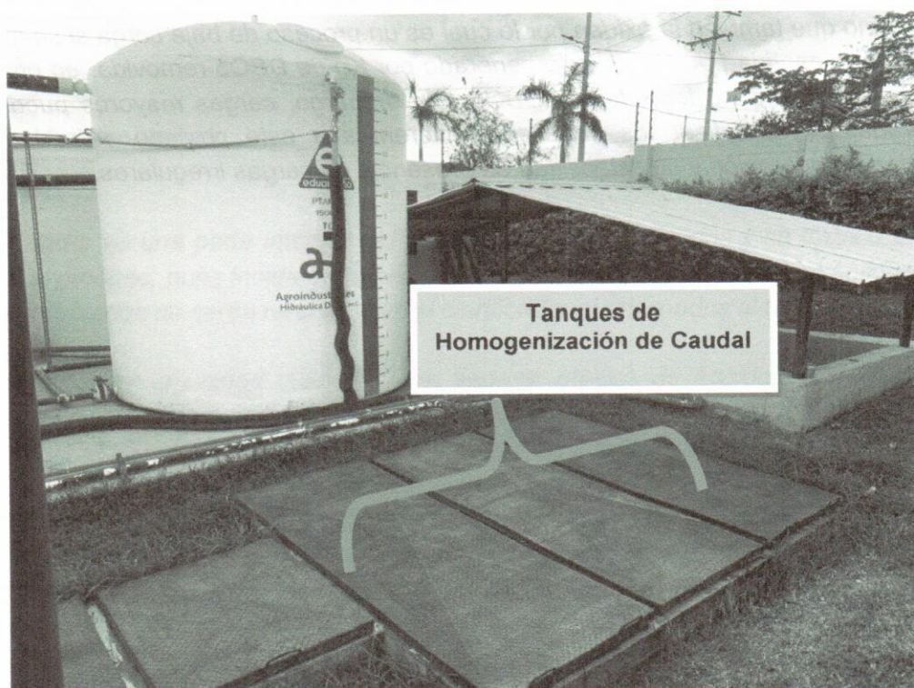
Foto 5. Tanques de Homogenización de Caudal (3 Unidades)
