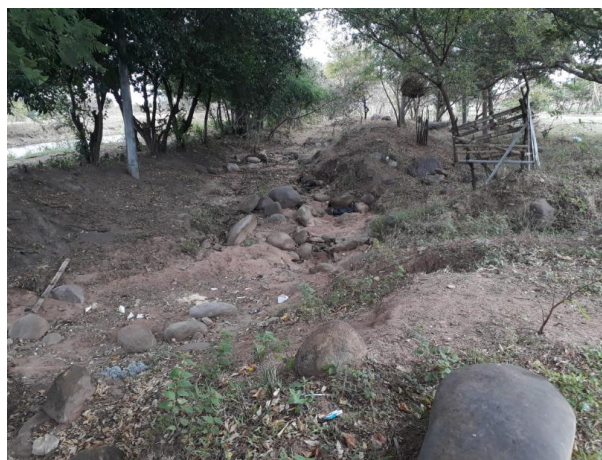
Figura 32. Desarrollo de erosión laminar por mal manejo de aguas de escorrentía
