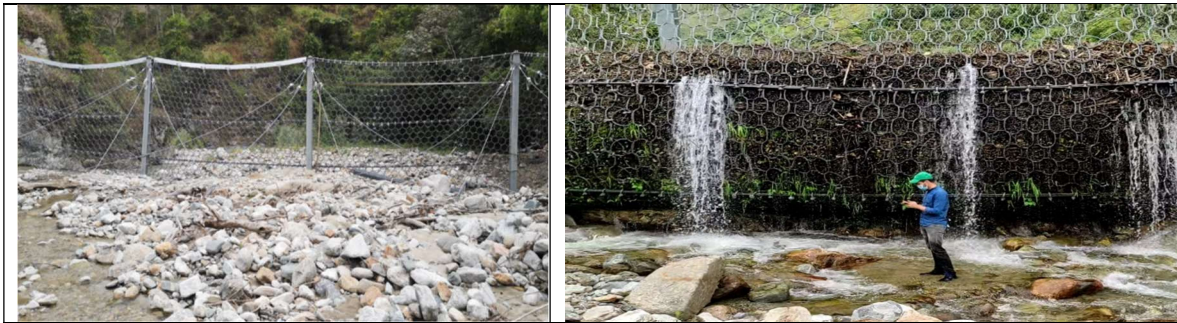
Barrera dinámica retención de detritos sobre el cauce de la quebrada Motilón
