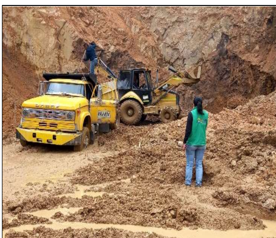
Actividad operativa de control / minería ilegal
