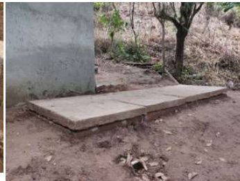
Sistema de Tratamiento vereda El Vergel
