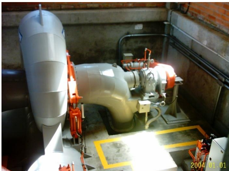
Foto 2.4 Turbina Francis de eje horizontal
