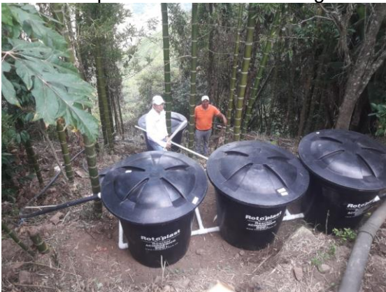
Sistema de tratamiento de aguas mieles de café, Edgar Ángel, vereda Chapuro
