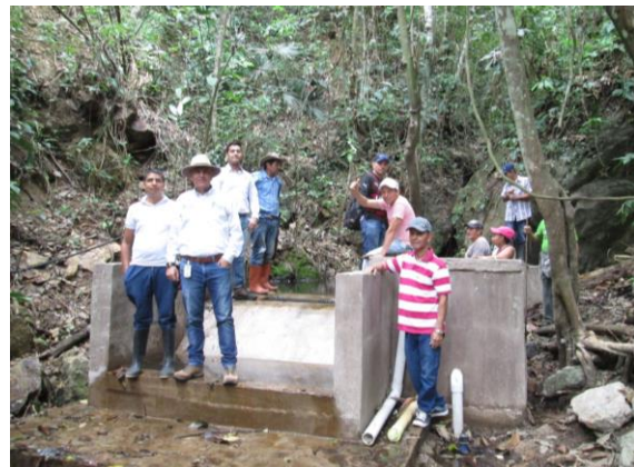
Bocatoma de Fondo
