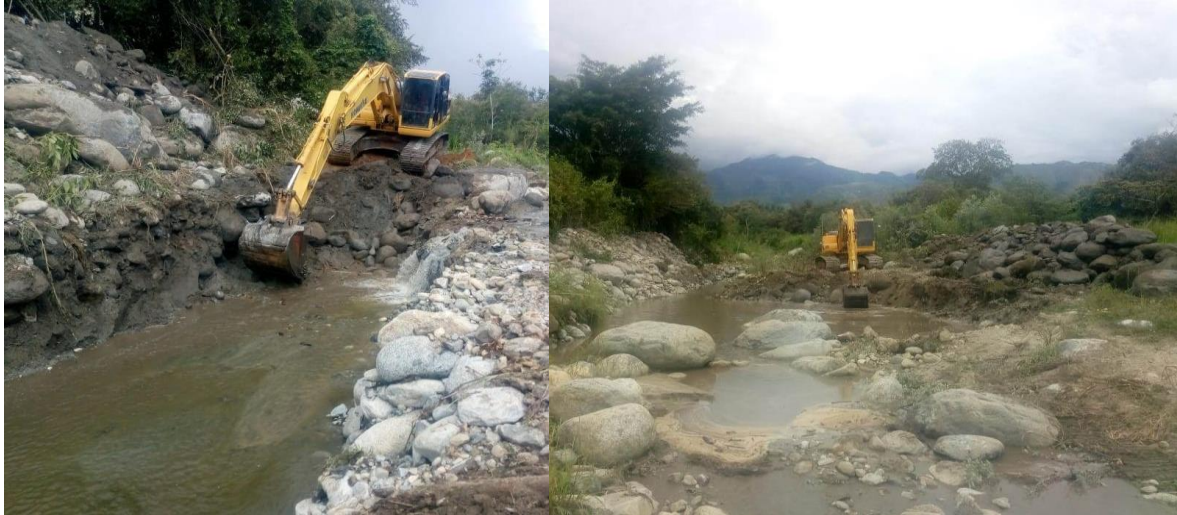
Evidencias de la ejecución de las labores de dragado y conformación de diques en el río Frío, en jurisdicción del municipio de Campoalegre.
