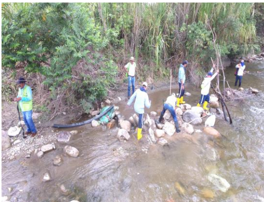
Desmante de estructuras que permiten captación de mayor cantidad de agua a lo permitido.
