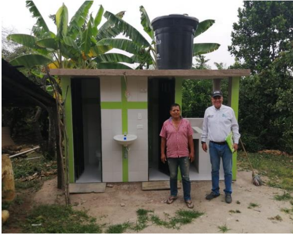
Batería Sanitaria vereda Santa Lucia Beneficiario Elcias Yagüe
